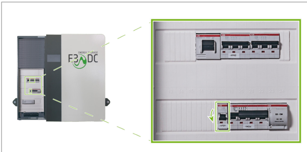
Abb. 11: LS-Automat für interne Versorgung ausschalten: 1F01 (Abbildung zeigt S10 E)
