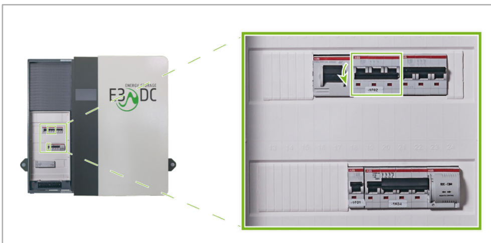
Abb. 10: LS-Automat für den E3/DC-Wechselrichter ausschalten: 1F02 (Abbildung zeigt S10 E)
